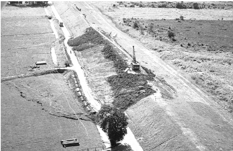
Abb. 1. Grundbruchähnliche Verdrückung beim binnenseitigen Deichausbau.
