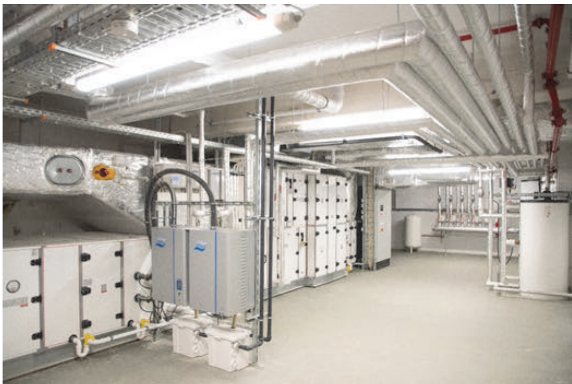
Abb. 6. Die Klimazentrale des Sammlungszentrums, 2023.
