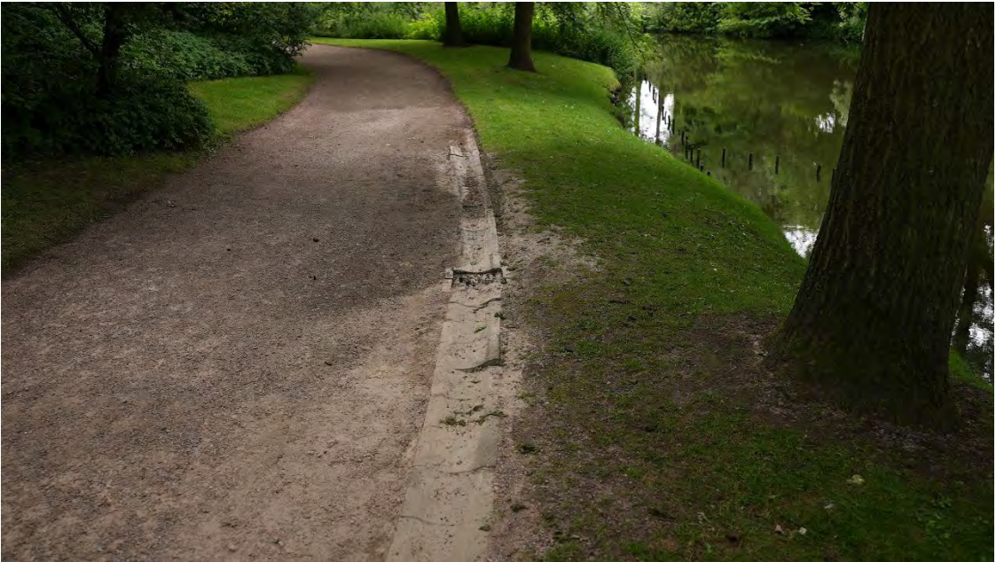
Abb. 5. Betonabwasserrinnen im Park begünstigen den raschen oberflächigen Wasserabfluss und verstärken Erosionsrinnen am Wegesrand. Quelle: Schlossmuseum Jever, 2022.
